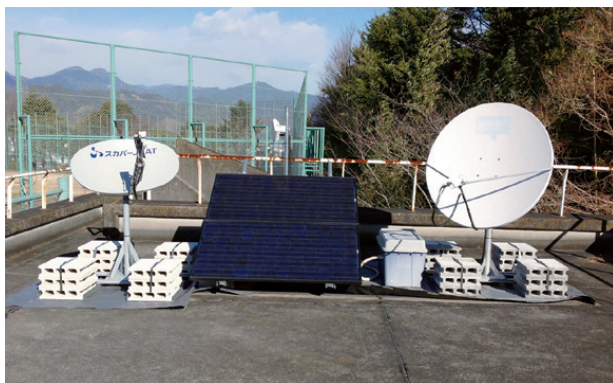
自立型防災通信ステーション
